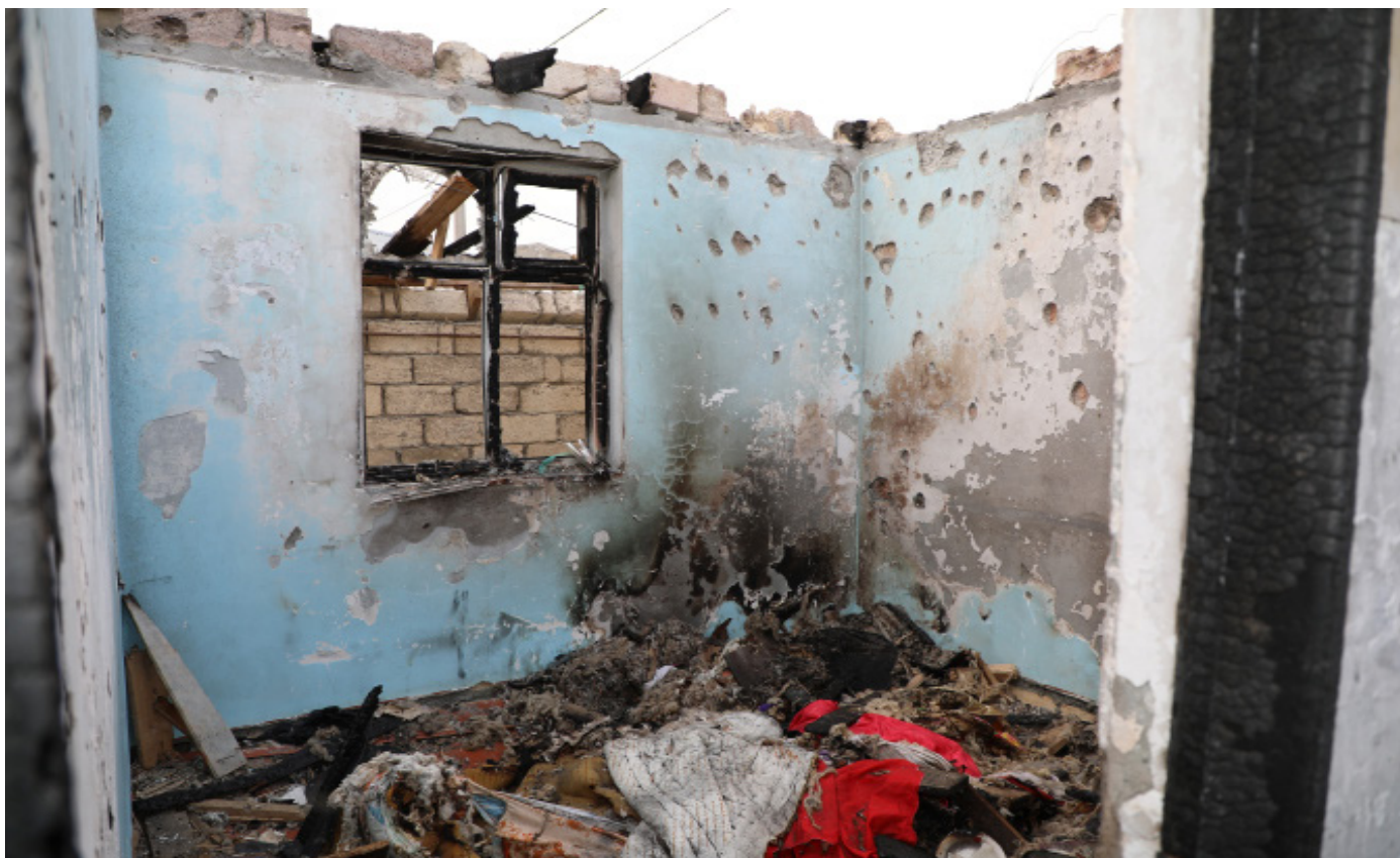
Azerbaïdjan, 2020. L'une des maisons les plus endommagées dans le camp de personnes déplacées de Quzanlı. © HCR/Elsevar Aghayev
